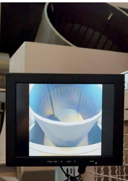
Die Be- und Entladung kann vom Schaltschrank aus per Videokamera überwacht werden.
