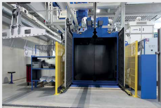
In der AGTOS Hängebahn-Strahlanlage HT 17-17 können Kleinteile automatisch gestrahlt werden.
