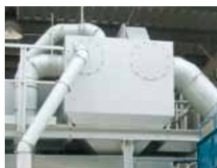
Skrzynia odbojowa do wstępnej separacji najgrubszych zanieczyszczeń
